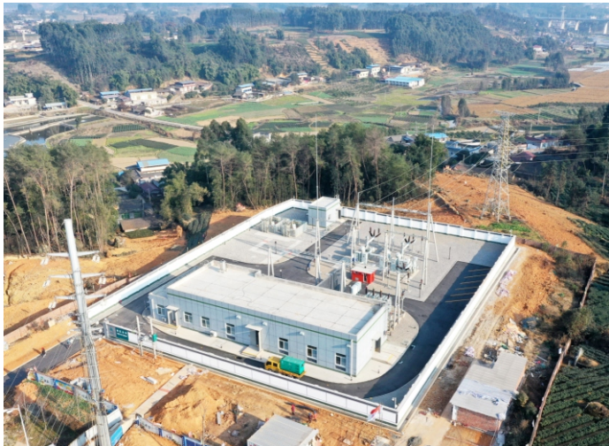
2021.1.24丰收110KV变电站投运
